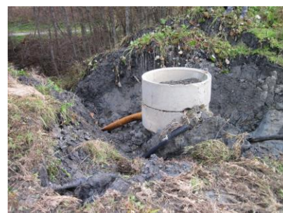
Figur 3 Stor erosjonsskade ved lukkingsanlegg
