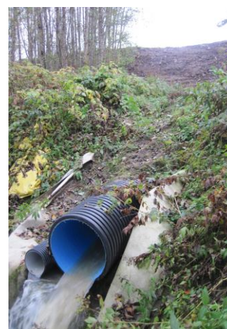
Figur 1 Sikret nedløp ved lukkinganlegg
