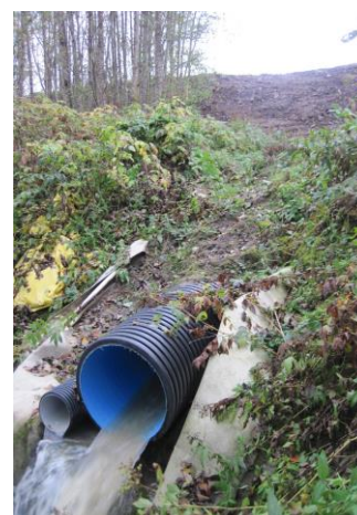
Figur 1 Sikret nedløp ved lukkinganlegg
